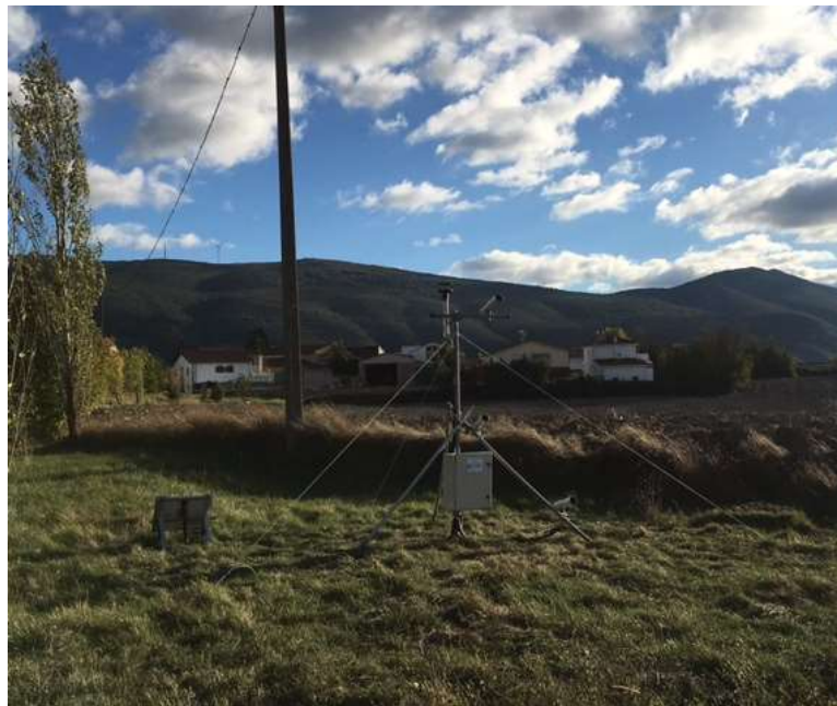
Figura 2 Imagen de estación de superficie instalada en Elorz.
